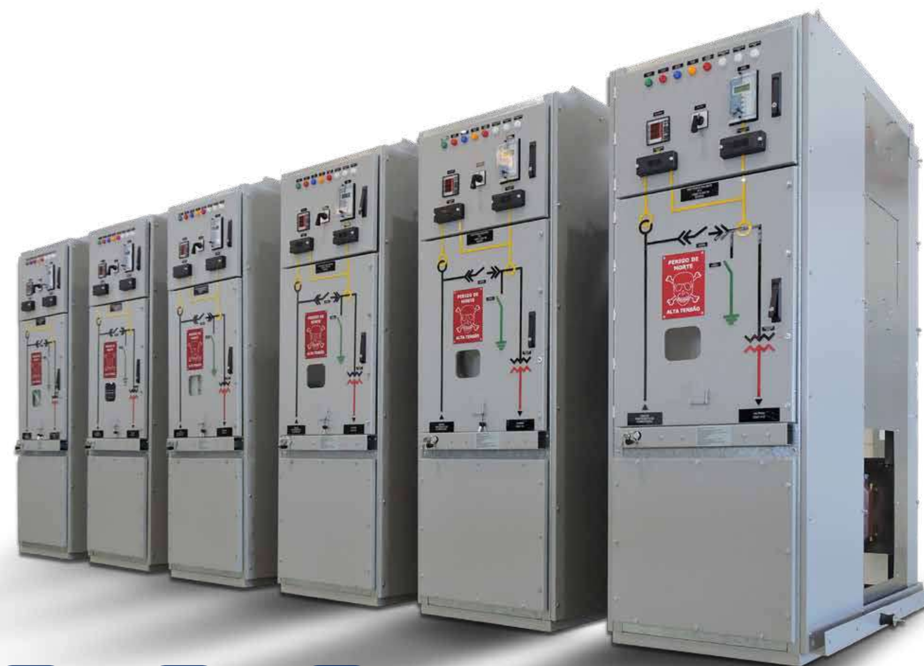
Equipamentos instalados na Usina de Itaipú.
